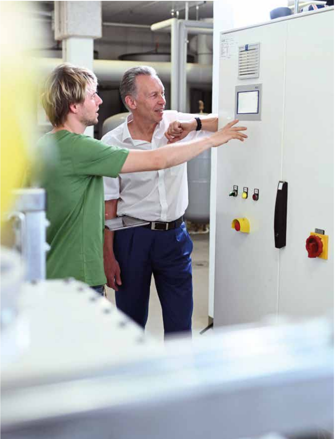
Heizzentrale im Quartier Möckernkiez mit Blockheizkraftwerk, Berlin
