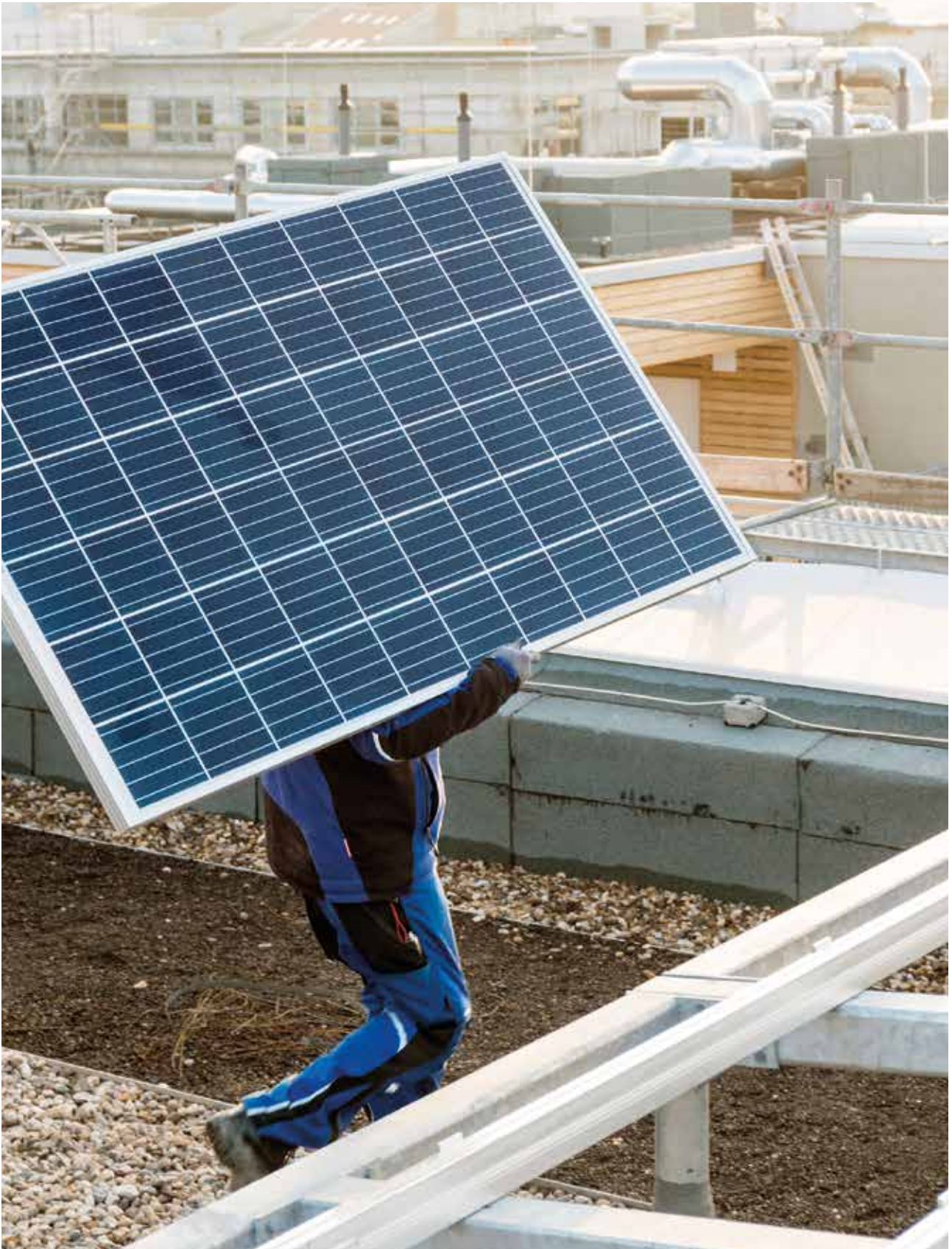
PV-Anlagen auf den Dächern des Möckernkiez, Berlin
