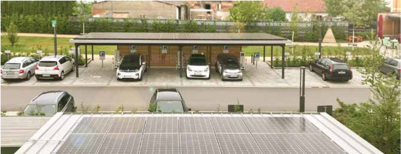
Solardach-Carport mit sechs Ladepunkten für Besucher, Mitarbeiter und Firmenfahrzeuge
