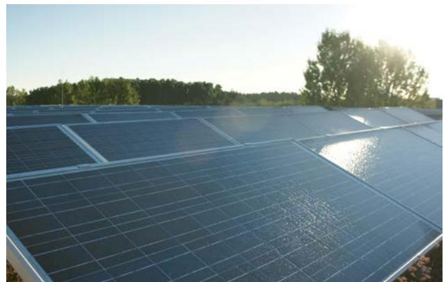
Photovoltaik-Anlage Max-Planck-Institut München
