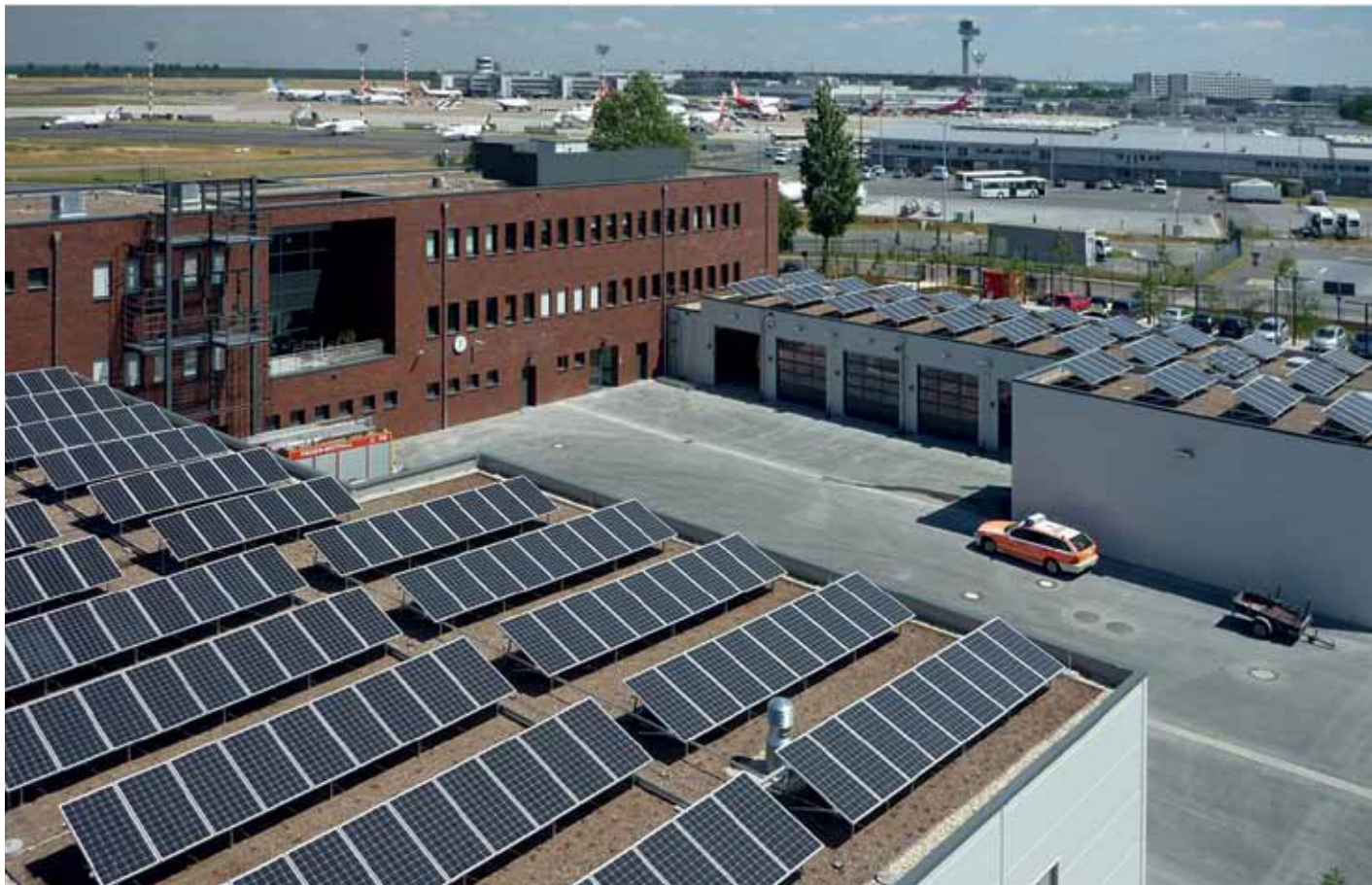
Naturstrom bringt am Firmensitz in Düsseldorf die Energiewende voran – mit einer Fotovoltaikanlage auf dem Dach der neu errichteten Feuerwache am Düsseldorfer Flughafen. Die Anlage hat eine Nennleistung von 52 kWp. Inbetriebnahme: Juni 2010
