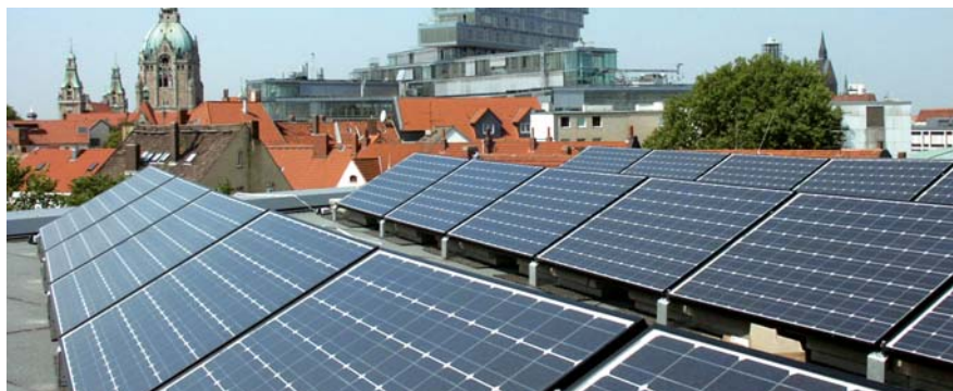
Von naturstrom geförderte Solaranlage auf dem Dach der Stadtbibliothek in Hannover.
