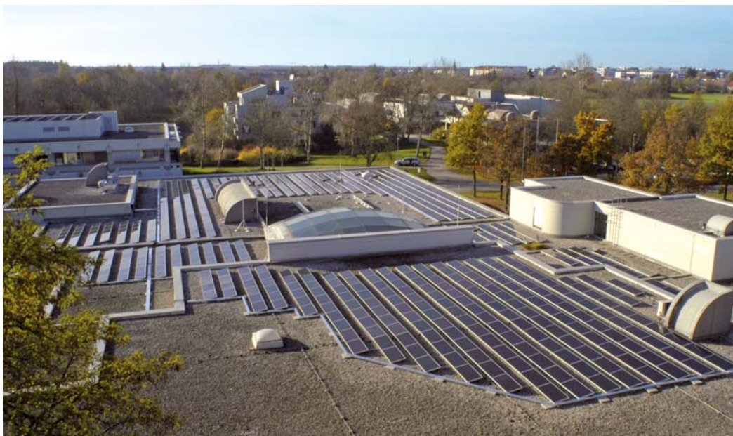
Eine der damals größten Photovoltaikanlagen Bayerns auf dem Dach der Max-Planck-Institute
