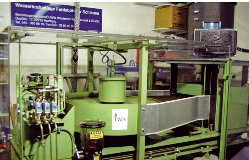
Turbine des Fuhlsbüttler Wasserkraftwerkes
