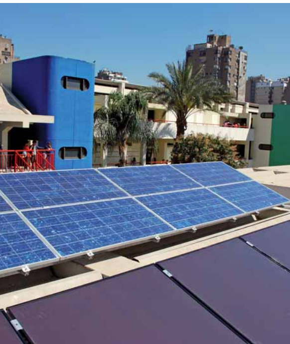
Dena-Solardachanlage an der Deutschen Evangelischen Oberschule in Kairo. Die netzgekoppelte 10,4 kWp große Photovoltaikanlage auf dem Dach der Schule besteht aus kristallinen und amorphen Solarmodulen (im Vordergrund).
