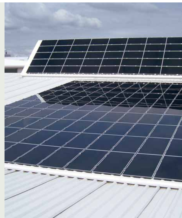
Photovoltaikanlage in Dingelstedt/Thüringen
